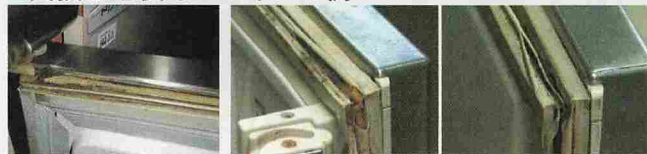
汚れ固着・黒カビ発生
